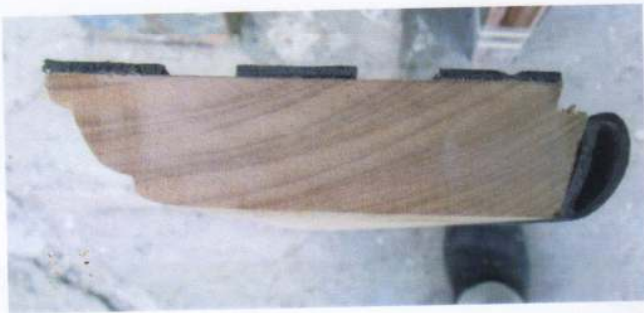
Foto 3: Detalhe da seção transversal do marco (notam-se a gaxeta de material tipo "borracha" e as tiras de espuma autoadesivas para vedação)
